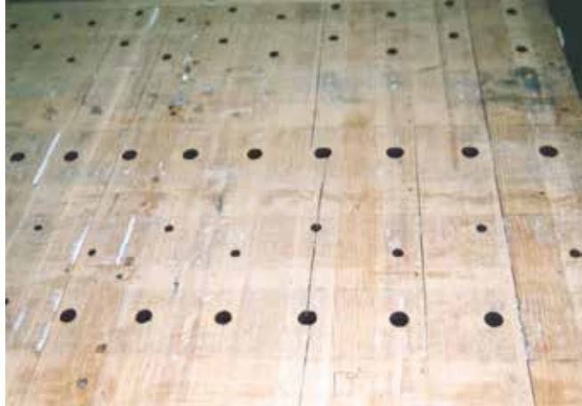
Scheuren in een houten windlade
